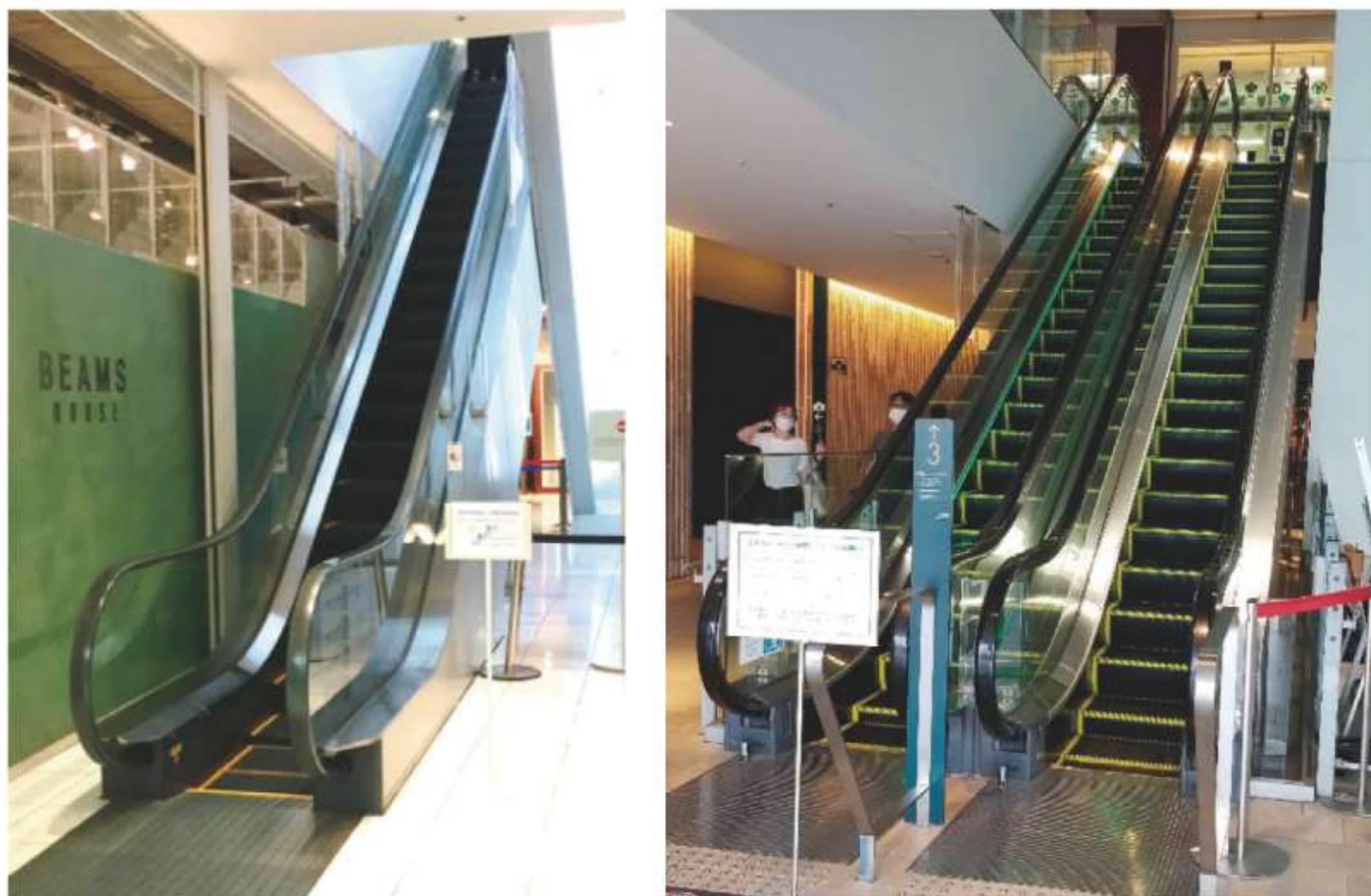
写真 3-1 勾配 35 度のエスカレーター(左)と勾配 30 度のエスカレーター(右) 丸の内ビル (左)、西武線練馬駅前の公共施設 (右) のエスカレーター。
