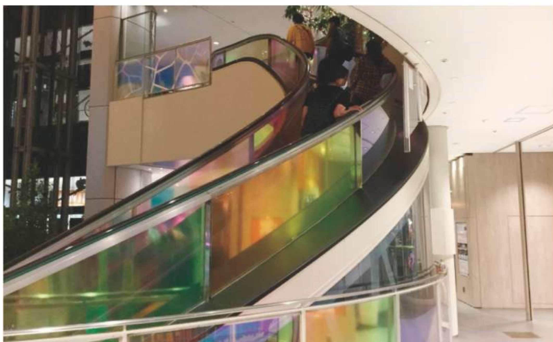
写真 1-6 らせんエスカレーター（心斎橋ビックステップ） 商業施設では、デザイン性を重視したエスカレーターが設置されることもあります。
